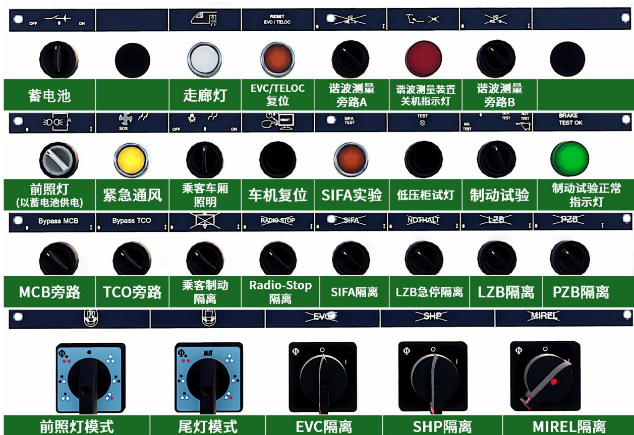
低压柜开关面板
